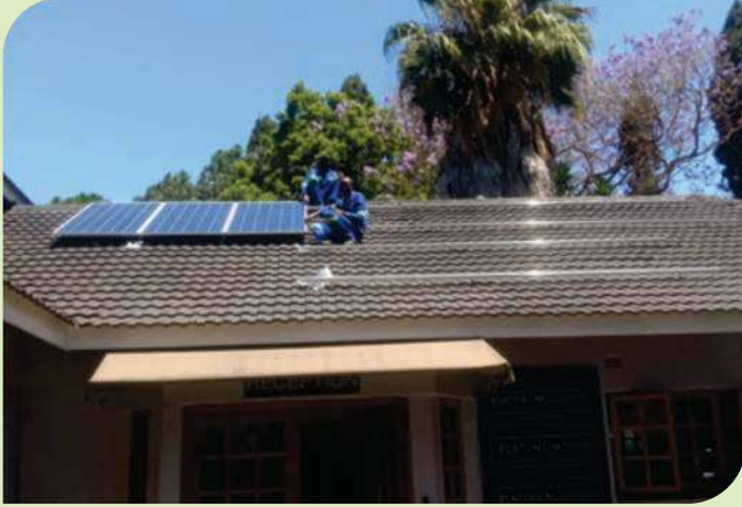
Platinum Groupe Head Office 10KW roof top installation
